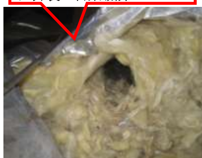
天井裏の営巣場所 断熱材を上手く利用して営巣
