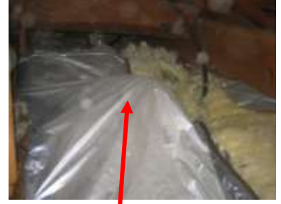
膨らんだ断熱材、中が営巣場所
