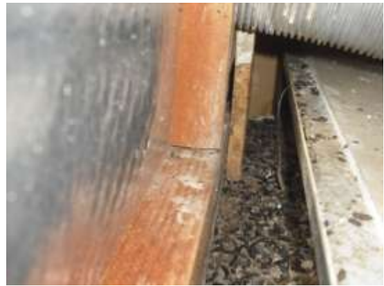
外壁近くのにユニット枠に糞が堆積
