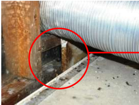
ユニットバスのダクト部分
