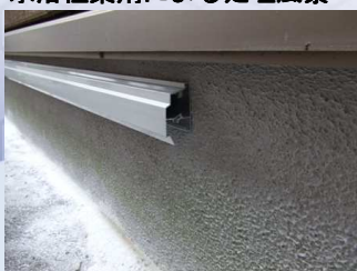
コンクリート基礎沿いに SC キーパーを取付 物理的侵入防止策
